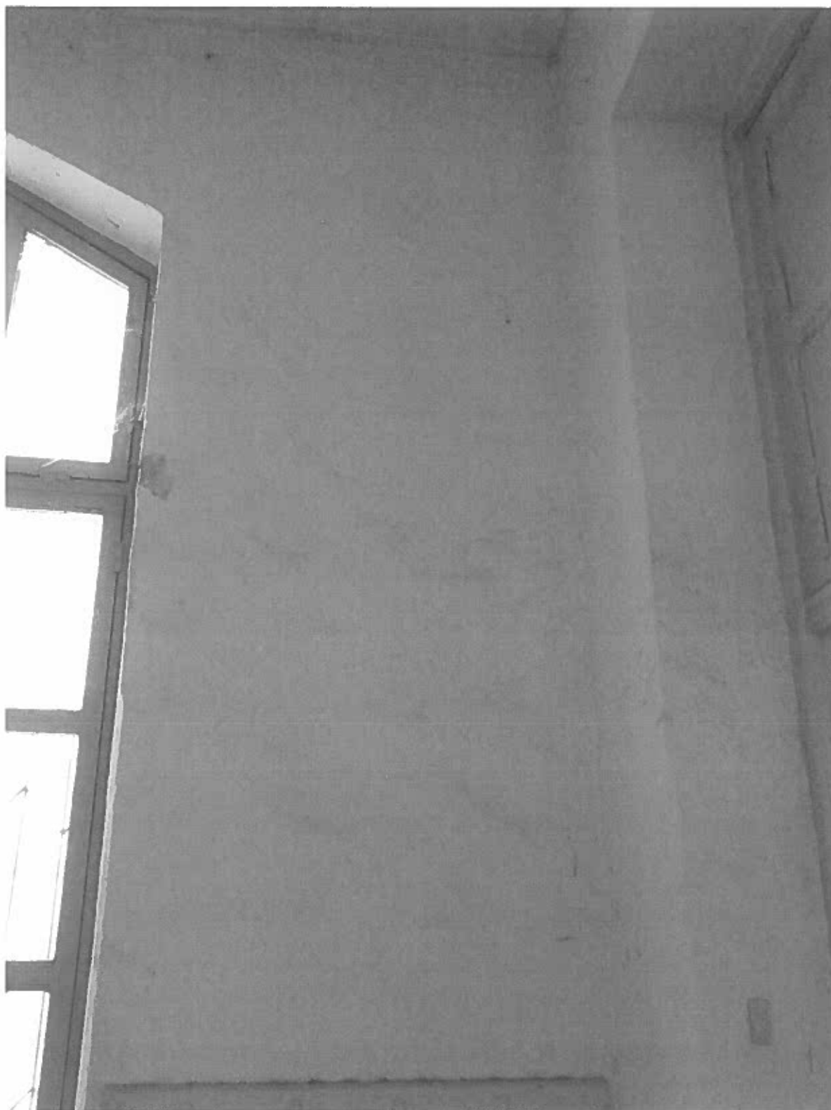
πιθανώς επιχρισμένες ρωγμές στο κλιμακοστάσιο
