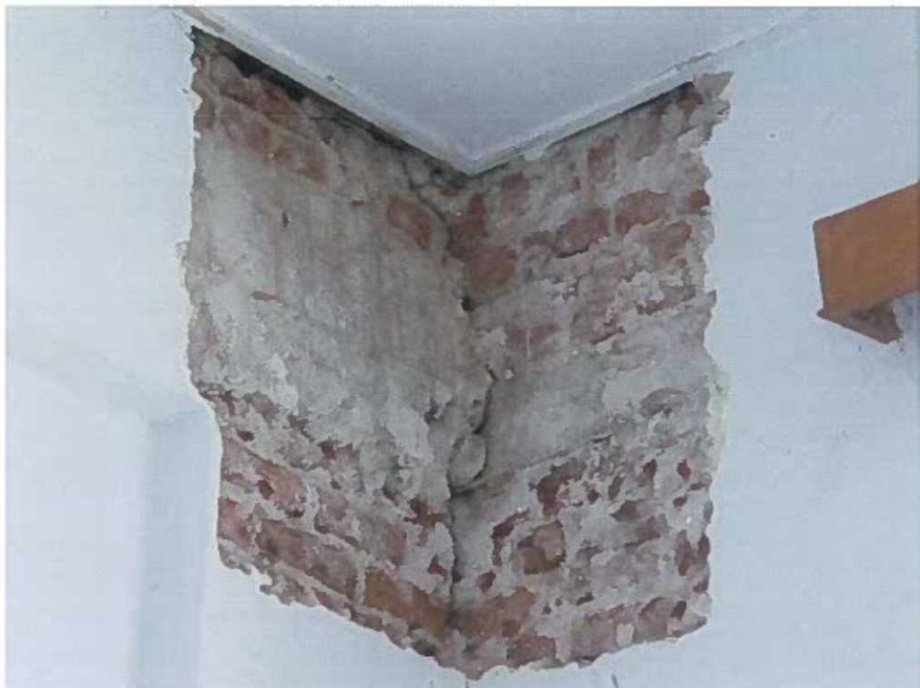
κατακόρυφη ρωγμή στην ένωση πεσσών (όροφος)
