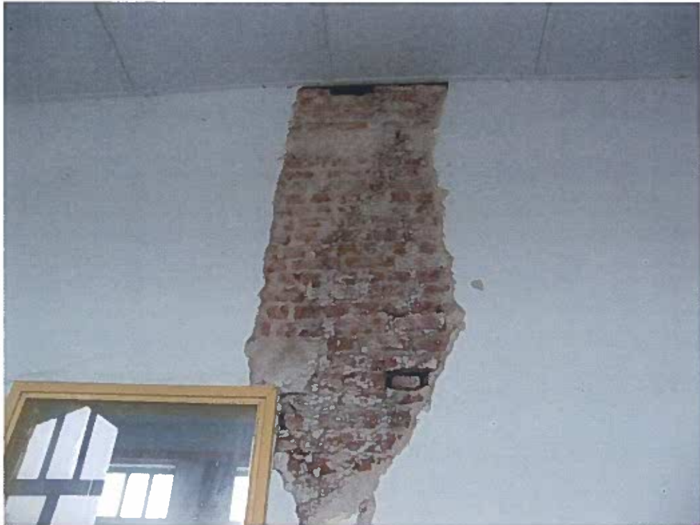
κατακόρυφη ρωγμή κεντρικού πεσσού (όροφος)
