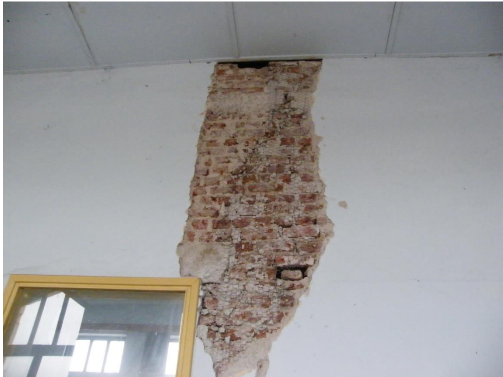
κατακόρυφη ρωγμή κεντρικού πεσσού (όροφος)
