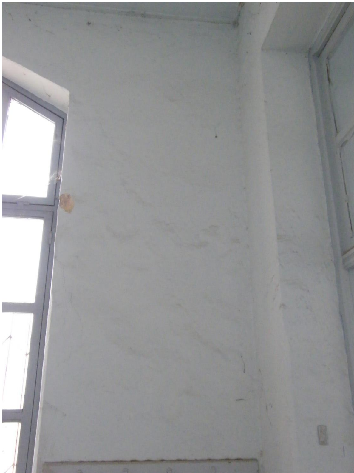
πιθανώς επιχρισμένες ρωγμές στο κλιμακοστάσιο
