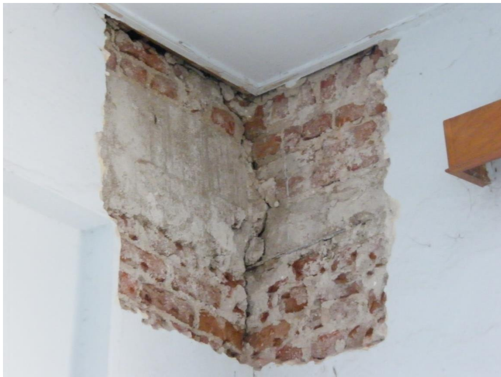
κατακόρυφη ρωγμή στην ένωση πεσσών (όροφος)
